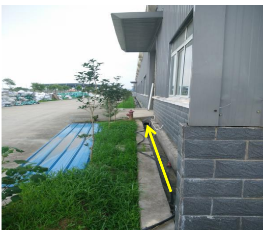
厂区雨水收集沟
