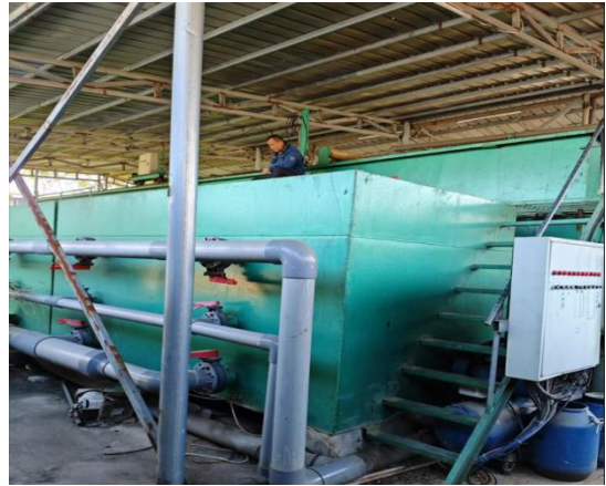
汽浮处理装置
