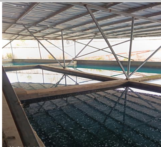
废水处理收集池
