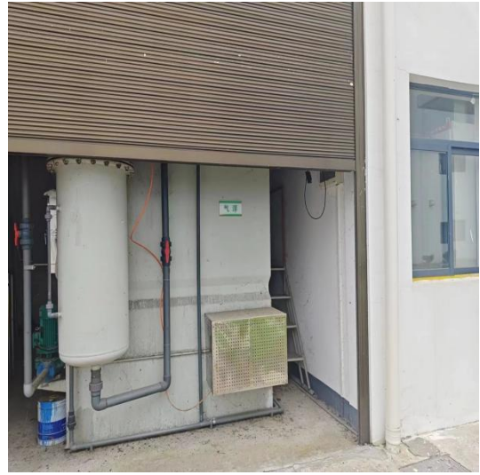
污水处理-气浮
