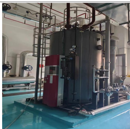
天然气锅炉4t/h
