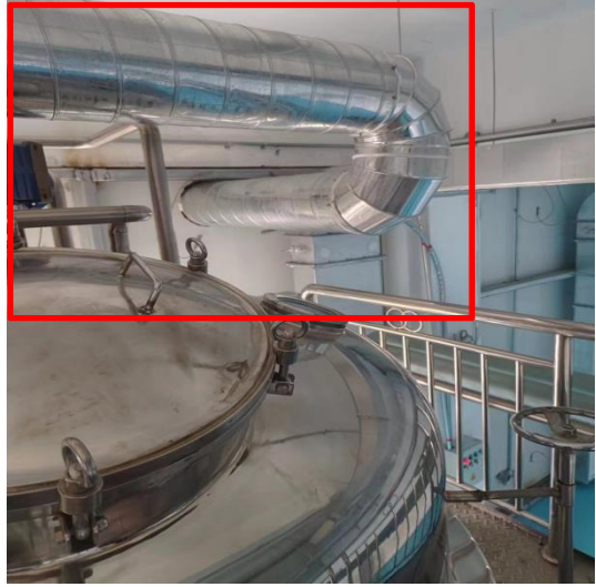
乙醇回收废气管道
