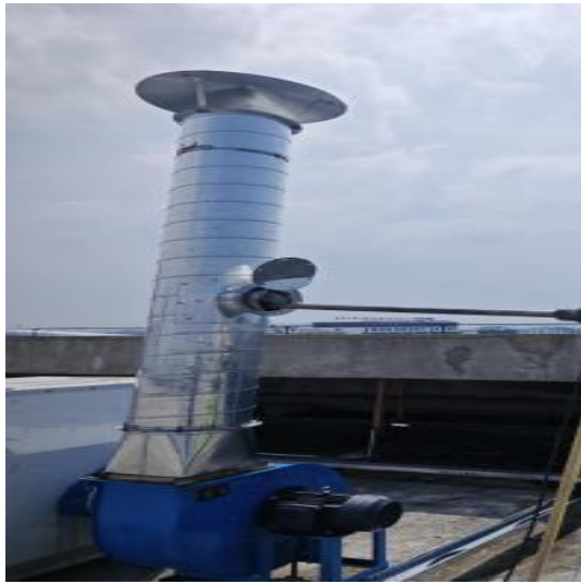
乙醇回收废气排气筒及处理装置
