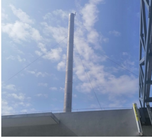
天然气锅炉排气筒（25m）
