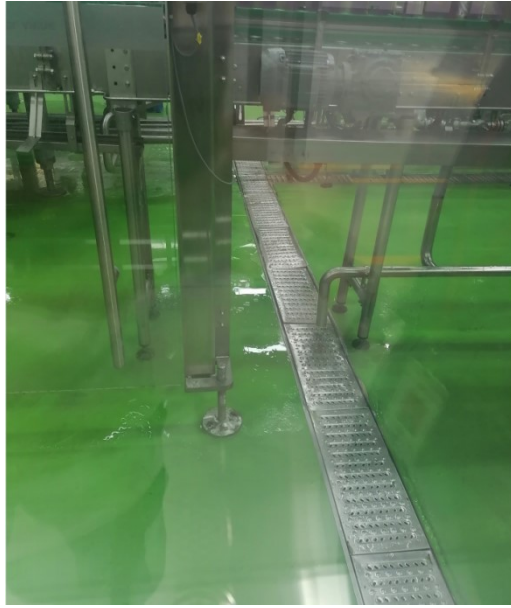
车间排水管网
