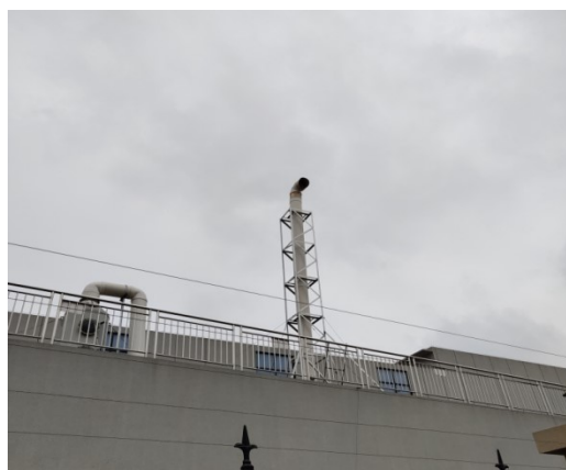
污水处理站恶臭排气筒
